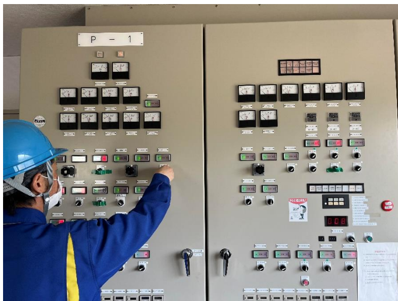
図3.技術点検員による制御盤の点検
