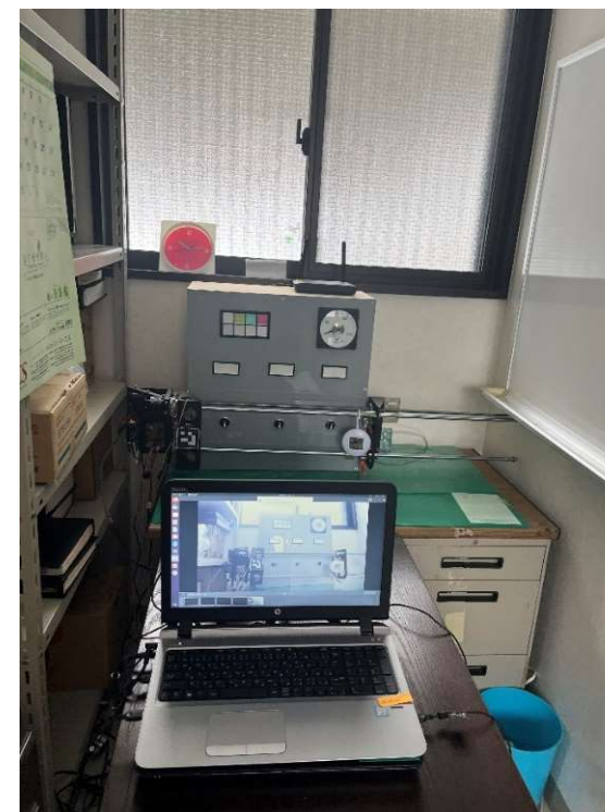
図4 施設内の制御盤の遠隔監視・操作
