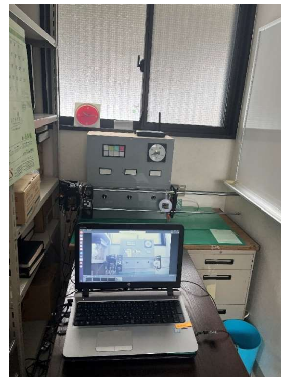
図4 施設内の制御盤の遠隔監視・操作
