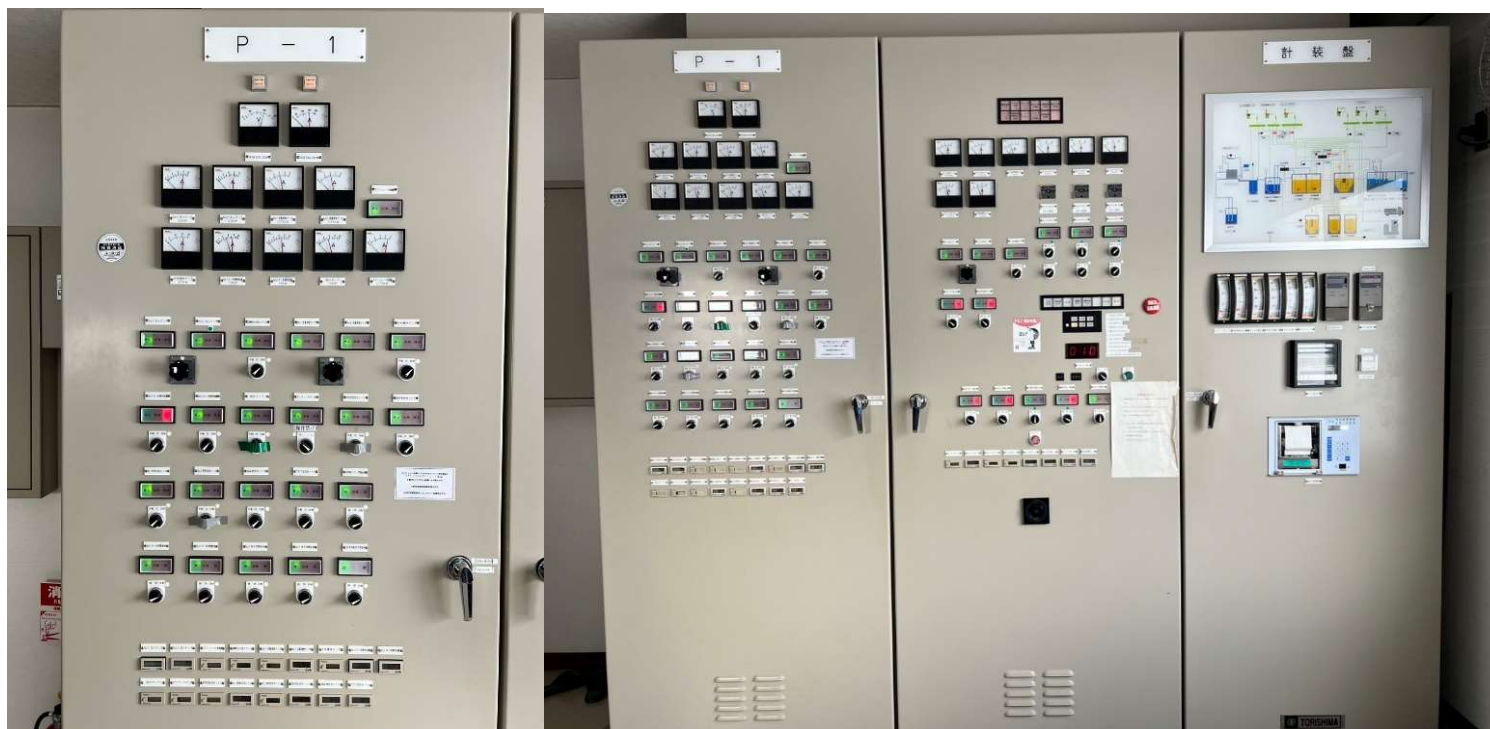
図7 それぞれの現場制御盤
